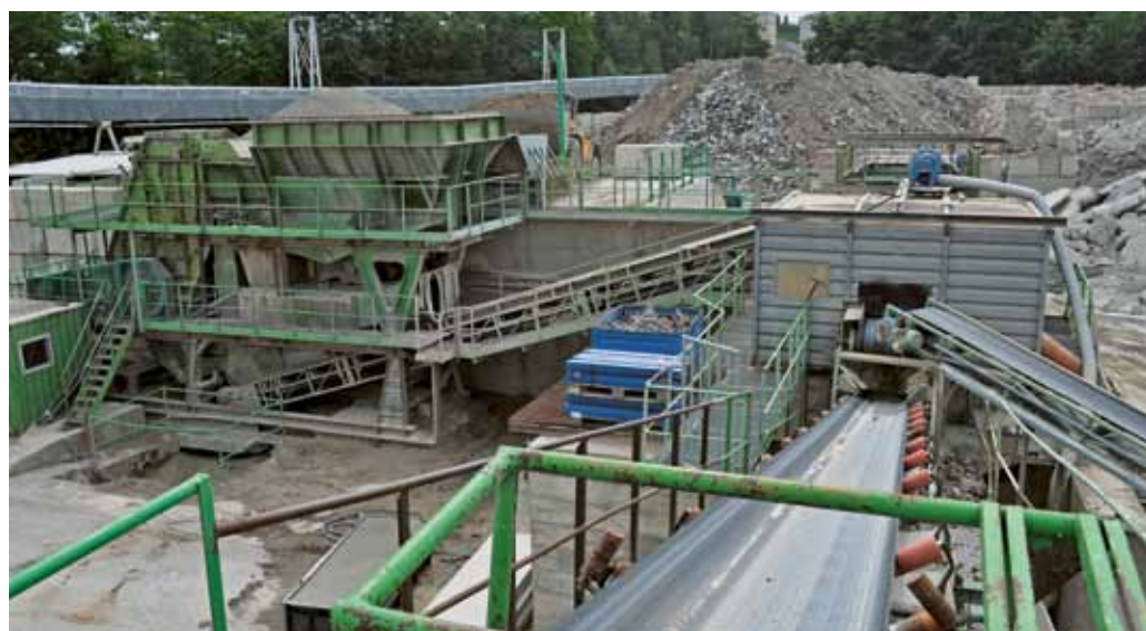
Dispositif de lubrification industriel sur concasseur
