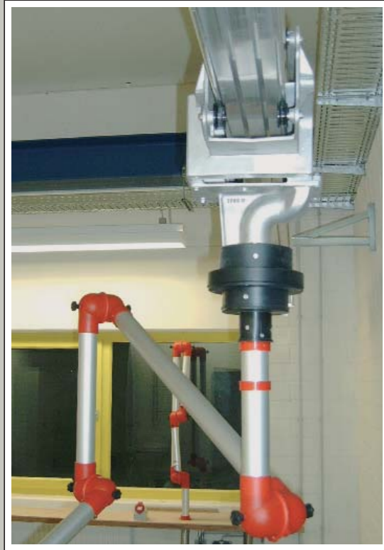
Hochvakuumabsaugung mit SSK 50 und Mini Absaugarm NW 50 an Polier- und Schleifplätzen von langen Werkstücken in der industriellen Bearbeitung von hochlegierten Stählen.
