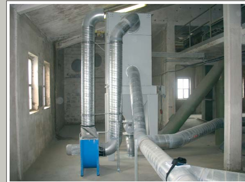
Atex-Patronenfilter – Zentralanlage 2000 m³/h für Absaugung im Silobereich mit Schneckenradaustrag zur Medienrückführung, einschließlich Expansionsklappe.
