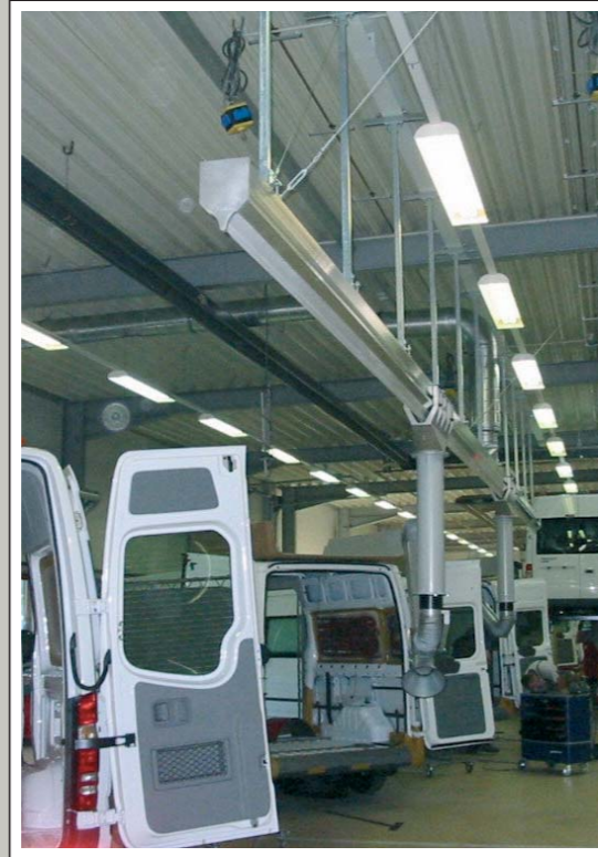
Saugschlitzkanal SSK 290 mit verfahrbaren Absaugarmen für die Schweißrauchf Erfassung in einer Transporterwerkstatt.
