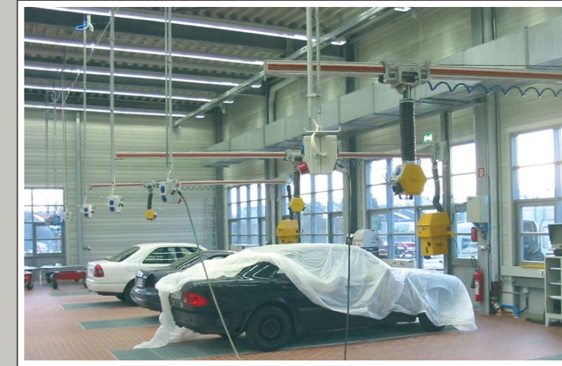
Hochvakuum Schleifstaubabsaugung in der Lackvorbereitung mit einem Staubkanal SSK 50 – 6 m lang, schwenkbar über je 2 Arbeitsplätze und in jedem Staubkanal einer verfahrbaren Energieversorgungsampel.
