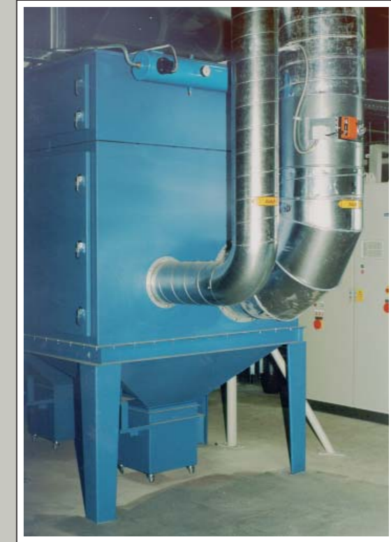
Patronenfilter – Zentralanlage für 12000 m³/h für Schweißrauch und Schleifplätze in einem Bahnbetriebswerk.
