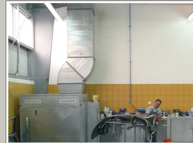
Überflur-Füllerabsaugung in einer Lackiervorbereitungshalle.
