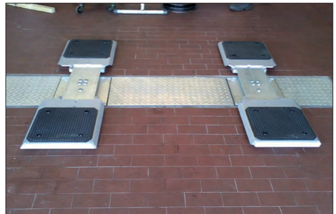
Neue Standard-Hebebühne fertig montiert.
