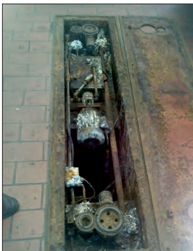
Vorhandene, verschlissene Hebebühne
