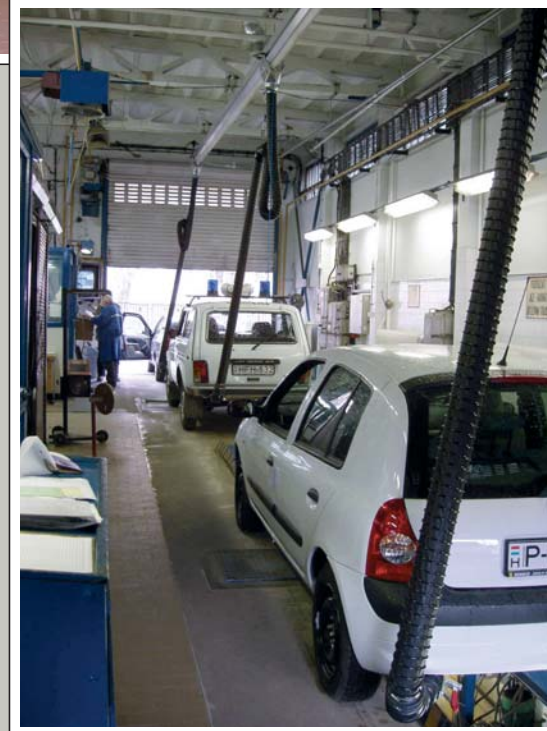
Saug Schlitzkanalanlage SSK 290 als Rundlaufanlage für technische Fahrzeugüberwachungsorganisationen mit hohem Fahrzeugaufkommen bis zu 150 Fahrzeuge pro Prüfspur.
