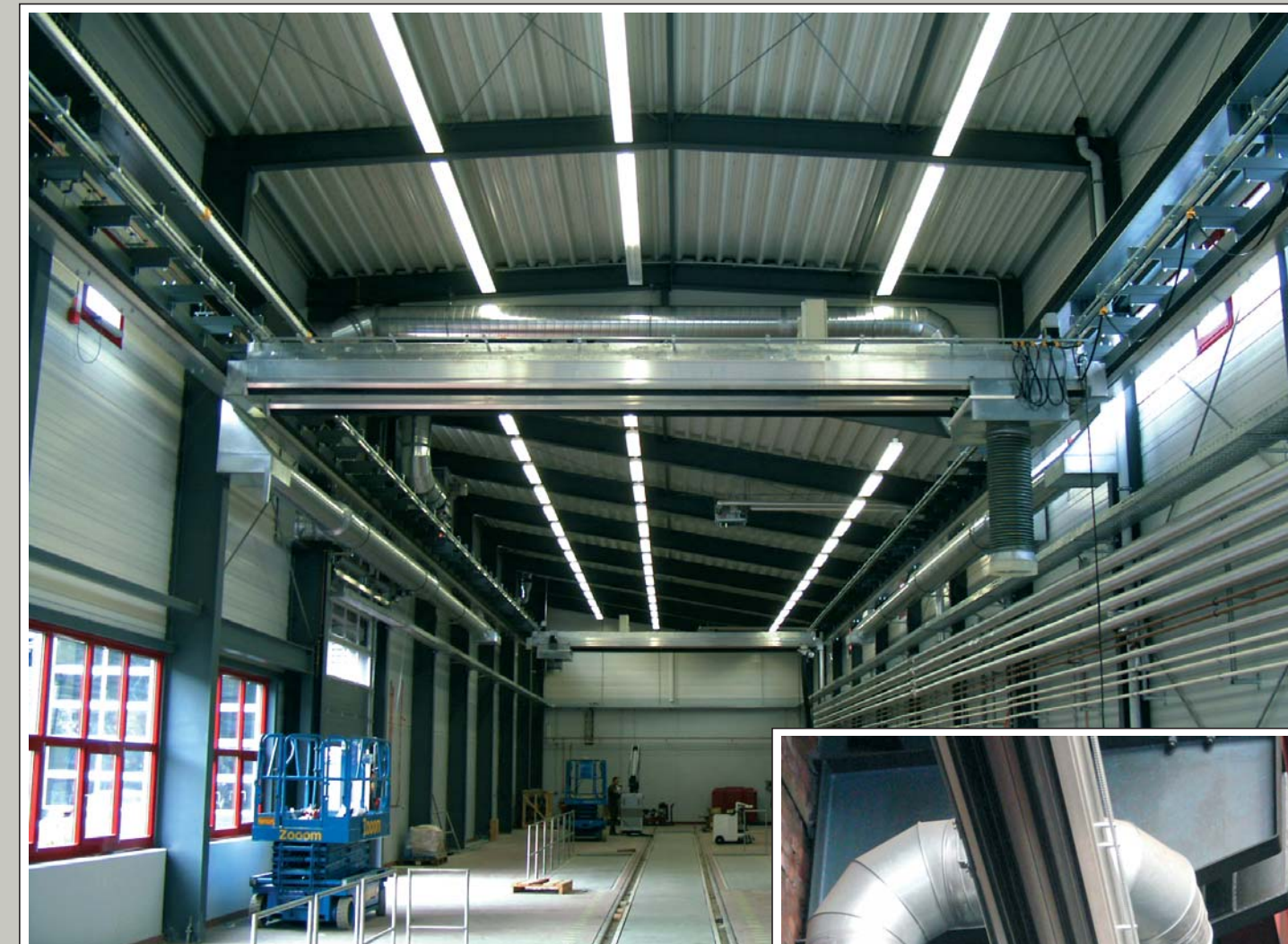
Saugschlitzkanal SSK 450 / SSK 900 im Koordinatensystem verfahrbar mit zwei Absaugbrücken für Dieselkabsaugung mit einer freien Spannweite von 12 m, längsverfahrbar 60 m. Die Anlage ist unterhalb einer Krananlage installiert und beide Systeme sind entsprechend den Sicherheitsvorschriften gegeneinander verriegelt. Die Bedienung erfolgt wahlweise über Schaltampeln oder mit Funkfernsteuerung. Die Absaugleistung kann bis 20.000 m 3 /h betragen.
