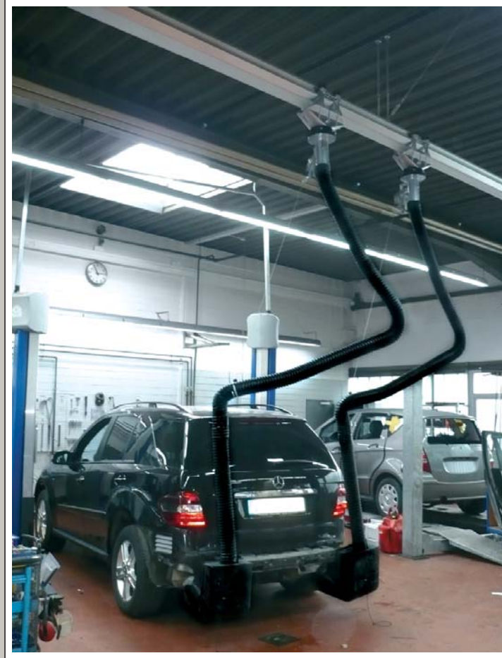
Zwei „SLS-Car“ Systeme im Saugschlitzkanal Typ SSK 150 „Verfahrbar“ für Fahrzeuge mit zweiflutigen Auspuffanlagen in einer Mercedes-Benz Werkstatt.
